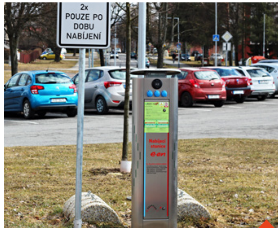
Elektrostanice na nabíjení elektromobilů ve Žďáru nad Sázavou
