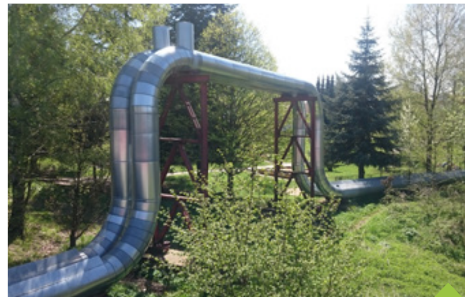
Teplovodní potrubí ve Žďáře nad Sázavou
