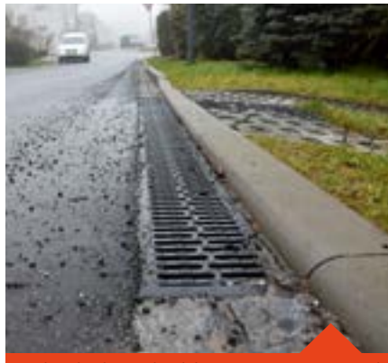
Mřížky odvodňovacího žlabu Foto: Matěj Papáček
