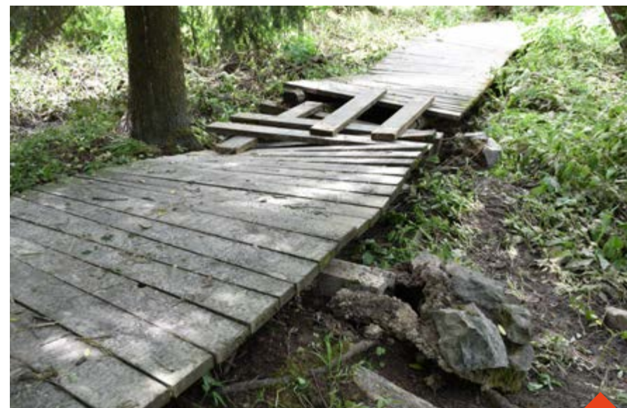
Poničená Konventská stezka po příválových deštích v červnu loňského roku
